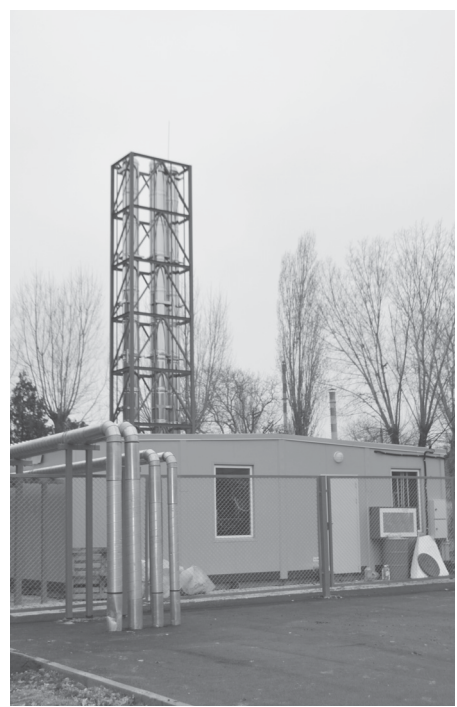
Новая котельная в Авиагородке
